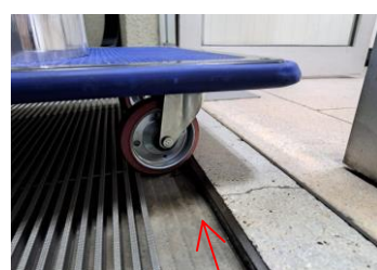
グレーチングの隙間部分 (施工前)
